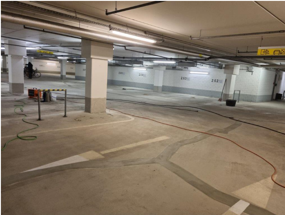
Bandagierte Risse im 2. UG
