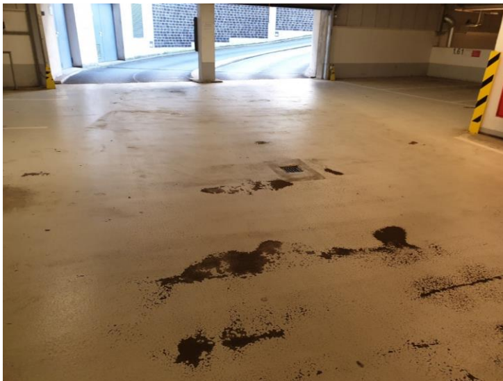
Schäden am OS-System im 1. UG
