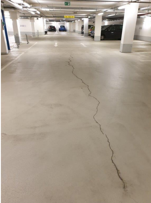
Risse in der Bodenplatte im 2. UG
